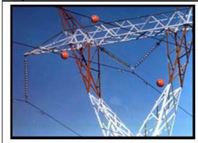
Figura 4-2. Señalamiento de líneas de tensión con esferas de un solo color
